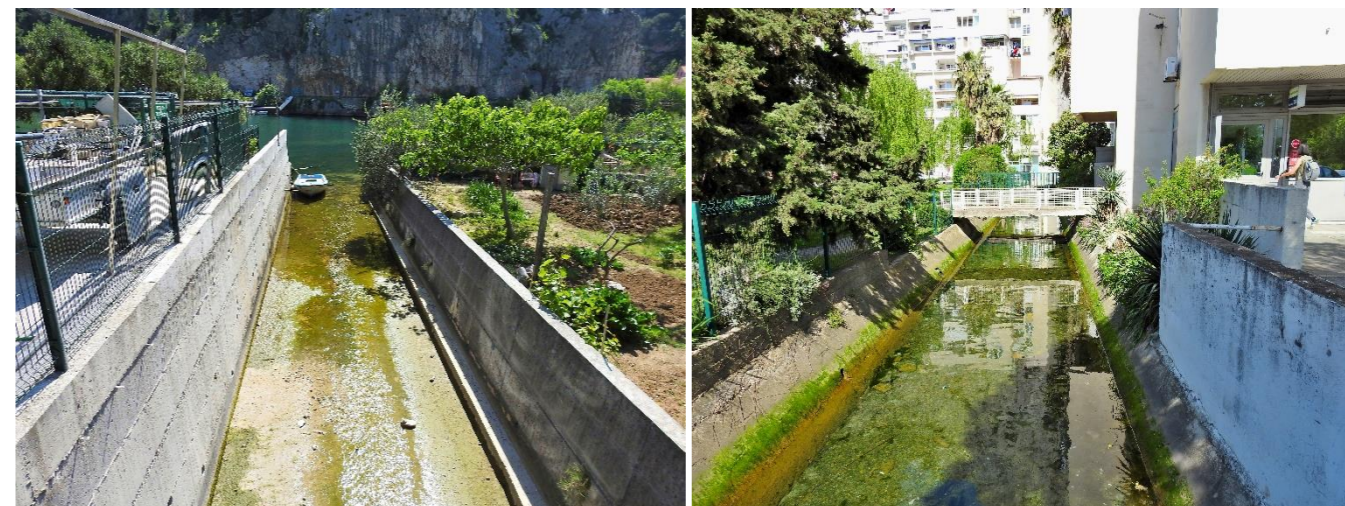
Sl. 112. Kanalizirana korita potoka Lisičine (lijevo) i Vrila s ispustima od oborinskih voda na Prikima
